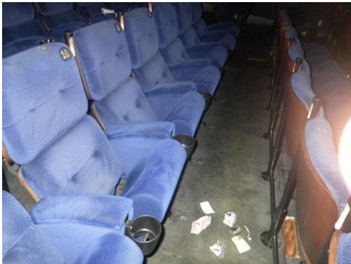
写真5 シアター内の焼損状況
